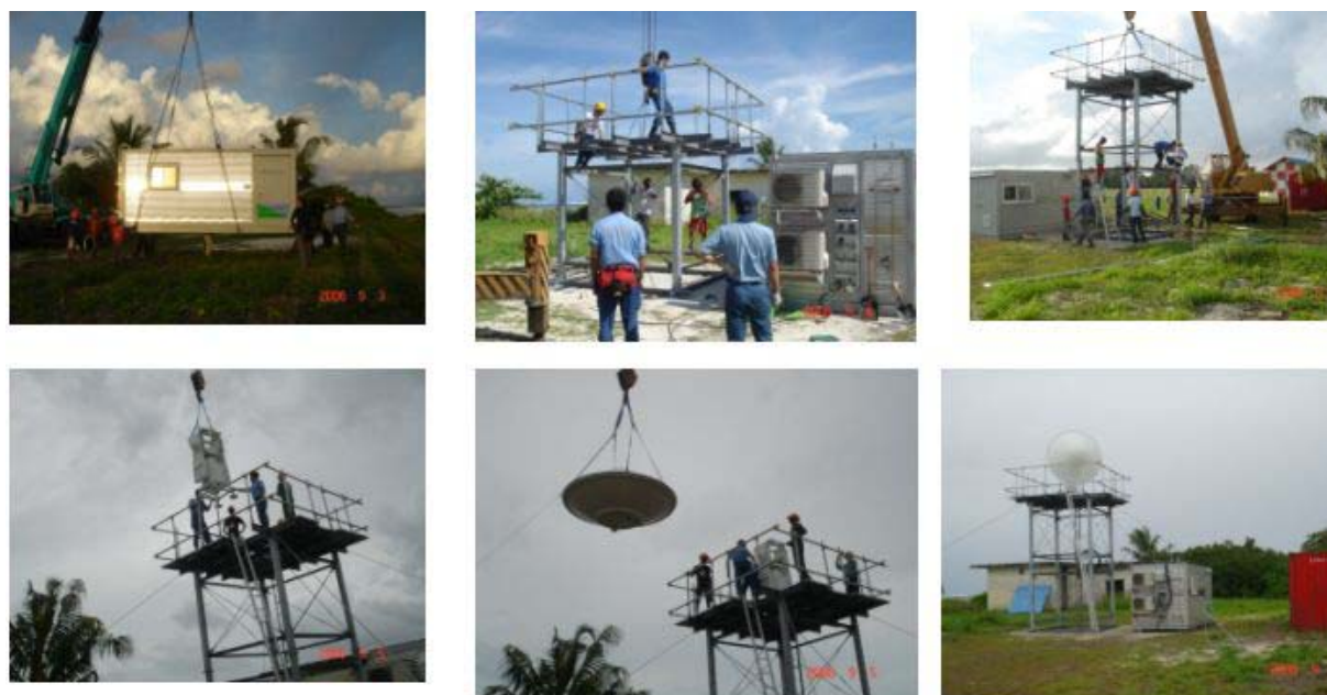
図 3 モルディブのガン島でのレーダー設置風景
