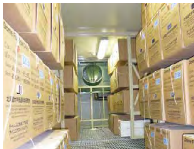
分析棟 超低温保存室
